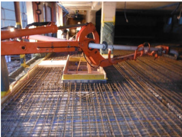
Fertig geschalter Prüfstand. Kontrolle der Lagerung vor dem Betonieren der Bodenplatte (Qualitätssicherung)
