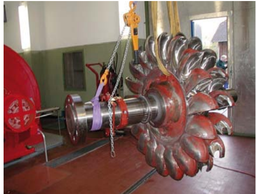
Abb. 2: Turbinenrad der alten Pelton-Turbine [4]
