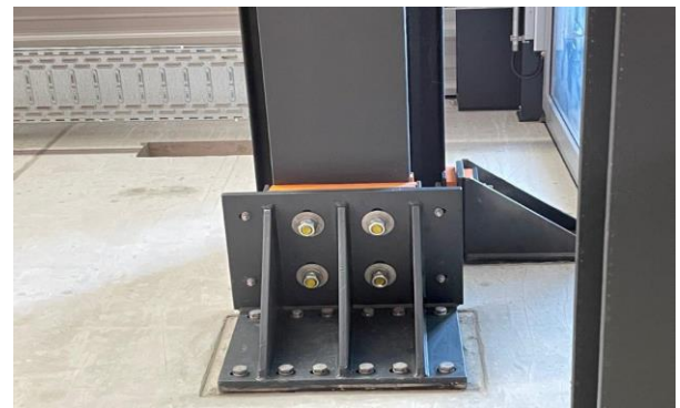
Vue d'en bas avec une console vissée au mur ainsi qu'une sécurité contre les forces transversales. Il est important que tous les points d'appui et fixations rigides soient découplés de manière durablement élastique et à basse fréquence, aussi bien par rapport au bâtiment que par rapport à la structure métallique
