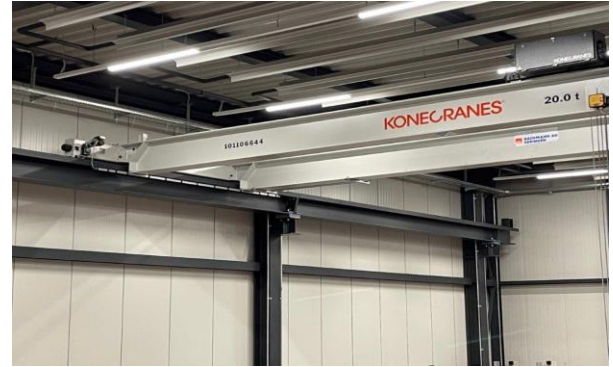
Pont roulant assurant le transport dans l'atelier d'entretien/réparation
